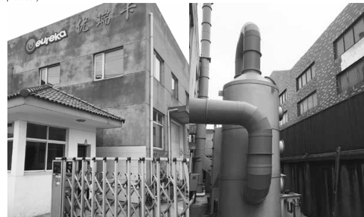
Fábrica da Eureka, na província de Jiangsu, China. Armazenamento, produção e instalações de laboratório húmido, subcontratados de costura (na fotografia, a entrada da fábrica e equipamentos de limpeza de ar de processo).
