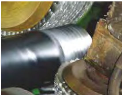
Spazzolatura di una testata di tubo con 2 rulli / Coating removal with 2 perpendicular roller brushes
